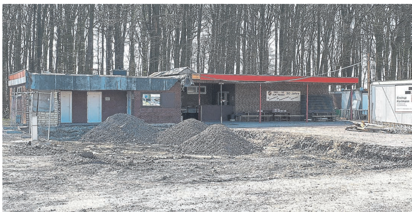
Das alte Clubheim der DJK Rödder ist am vergangenen Wochenende komplett abgerissen worden. Die Fachfirma hat schon den ersten Schotter für das neue Fundament eingebracht. Die Fläche des neuen Gebäudes wird größer sein.
