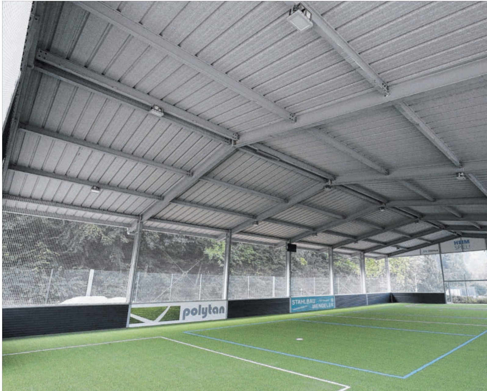
In der neuen Albwerk-Arena kann bei Wind und Wetter Sport getrieben werden – in zwei Wochen wird sie eingeweiht.
